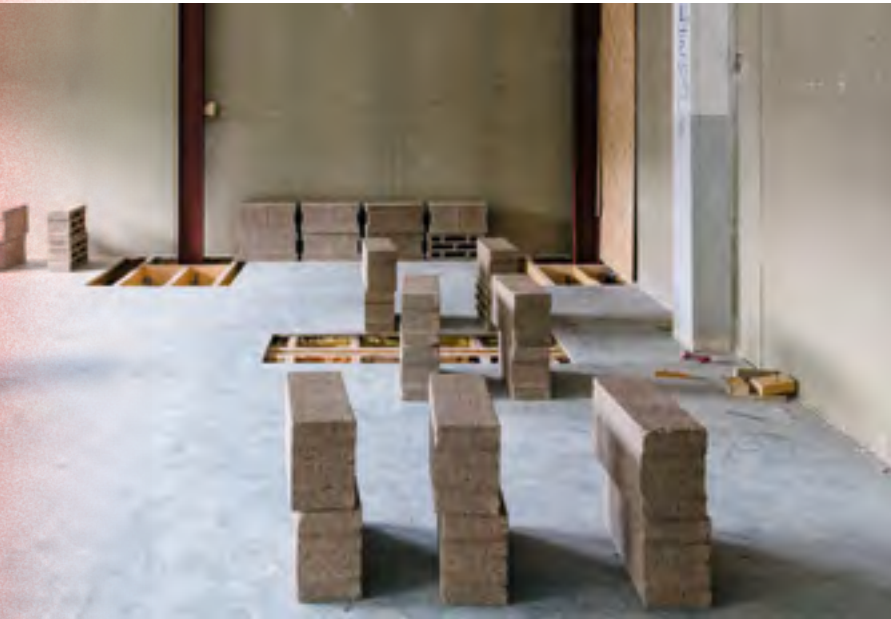
Création des ouvertures dans le plancher du rez-de-chaussée pour les nouvelles fondations.
