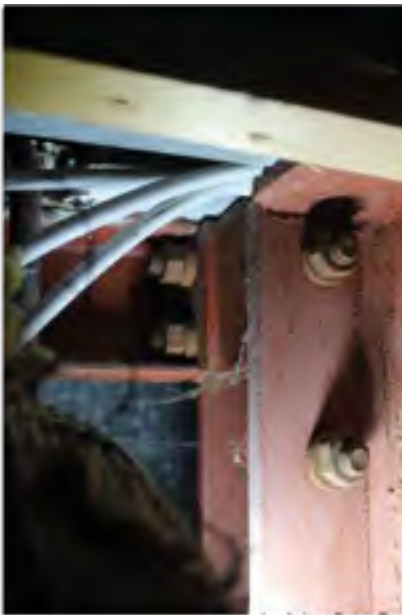
Bild 37: Blick auf den Anschluss in der Achse Ü-14, Fassadenstütze HEA 120, Unterzug IPE 300 sowie dem U-Profil U100, Nr. 36
